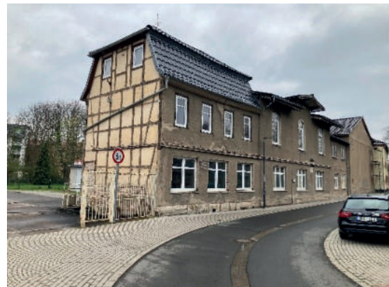
Abb. 87: Erheblicher Sanierungsbedarf an der Einmündung Hagebuttengraben in die Tonbergstraße (Quelle: Eigene Abbildung 2023)
